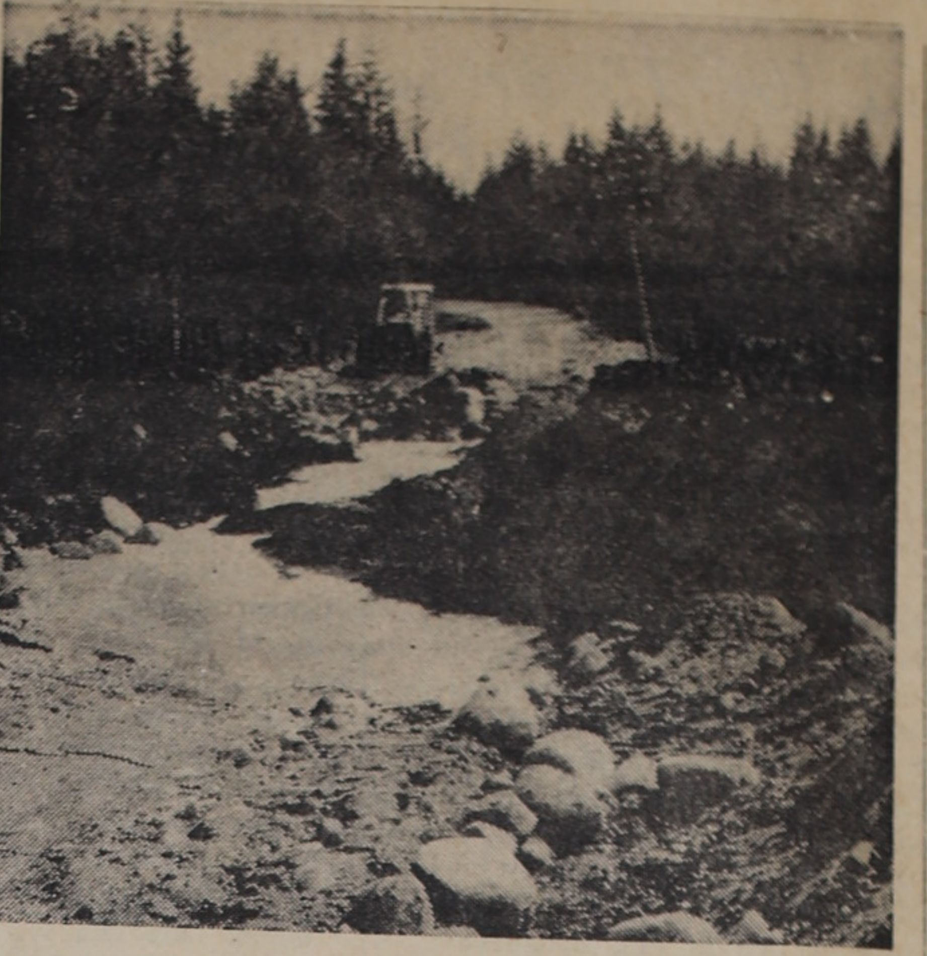
Vägbanan sjönk en meter på en sträcka av cirka 15 meter. En konande krater bildades.
