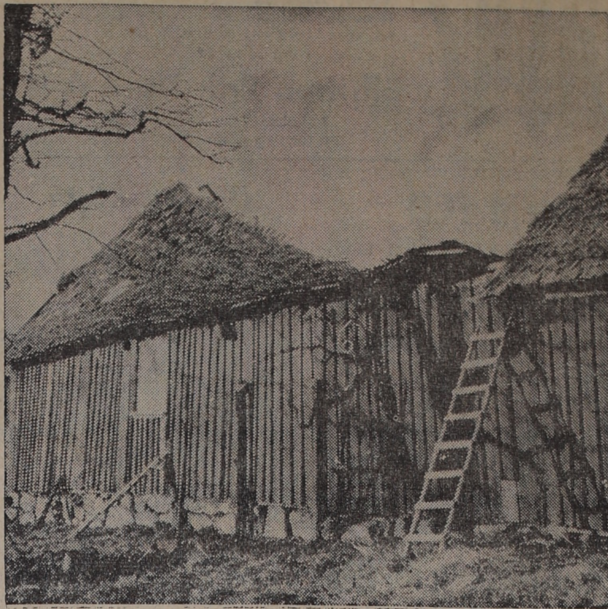
På en ladugård i Vinberg blåste taket av.
