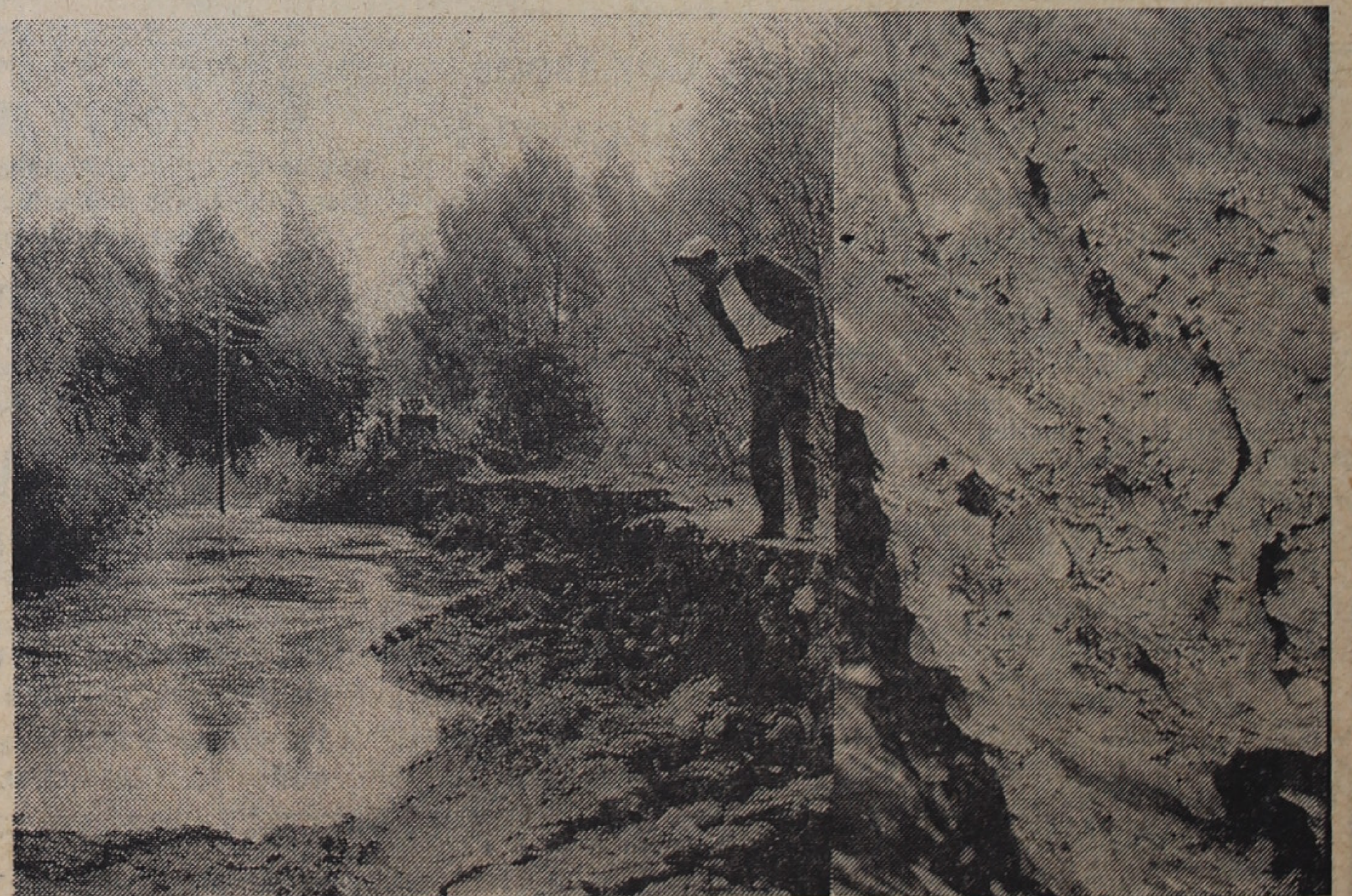
Kommunalarb. Göte Nilsson stderar förödelsten. Sprickorna till höger varslar om nya ras.
